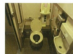
車いす対応トイレ
