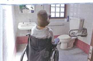
車いす対応トイレ（女子）
