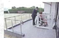
宍道湖側テラスに出るための昇降機
