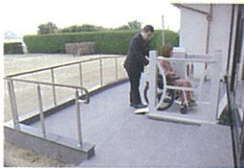
中庭の出入口に新設された昇降機
